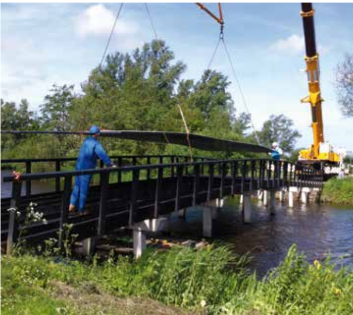
Razendsnelle plaatsing van een vloeistofdicht 15 x 4m InfraCore® Inside brugdek in Zaandam.
