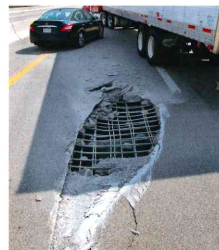
Schade aan het wegdek op een viaduct. Dit is relatief eenvoudig te herstellen met de SUREbridge-technologie.
