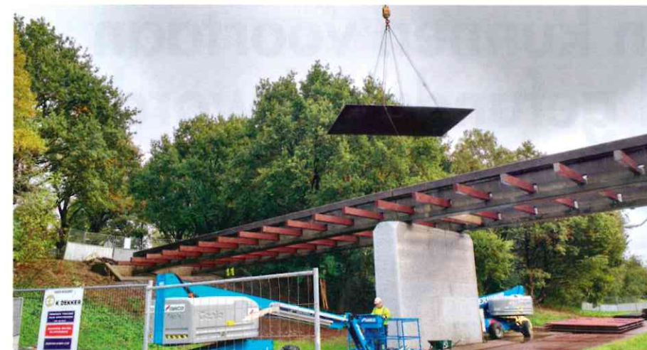
De panelen zijn eenvoudig aan te brengen met minieme overlast voor de omgeving, zoals hier bij een brug in Amsterdam.
