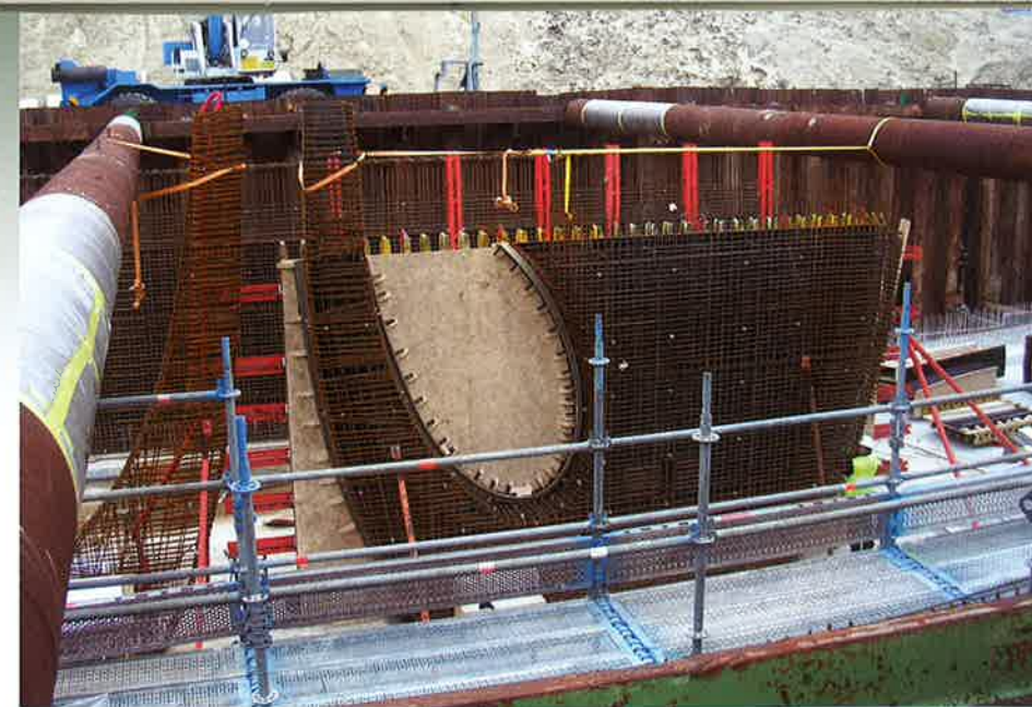
De bouw van de middenkolom. De wapening is goed te zien (foto: Royal HaskoningDHV)
