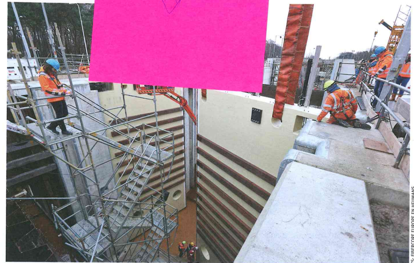
De vervanging van de sluisdeuren is onderdeel van een renovatie van het Wilhelminakanaal bij Tilburg, dat breder en dieper wordt gemaakt.
