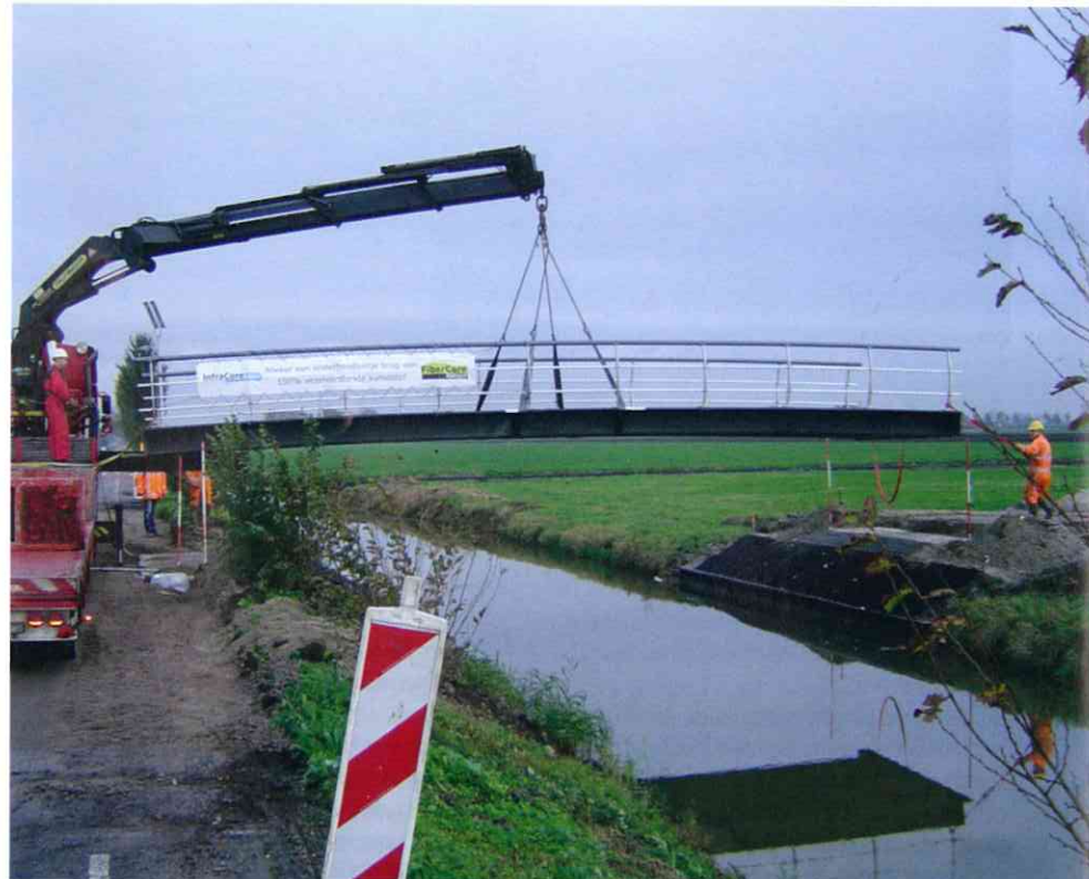
Doordat montage van de duurzame brug direct van de auto kan plaatsvinden, vaak gecombineerd met een fundatie op staal, wordt de inzet van montage- en heikranen tot een minimum beperkt.
