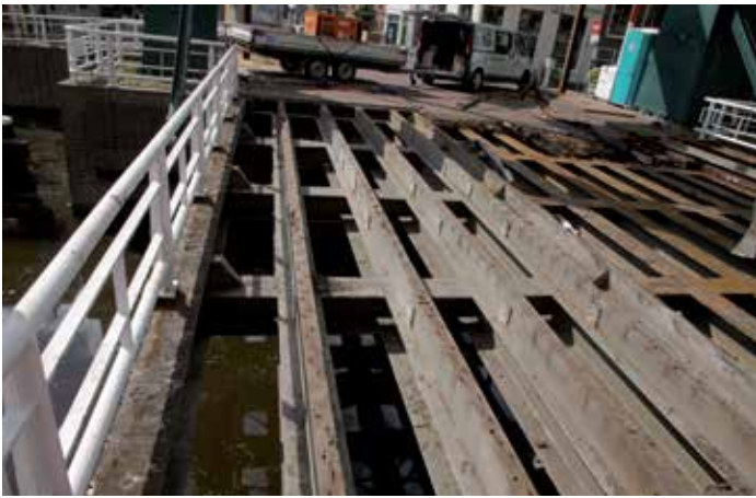
Däckrenovering: Den ursprungliga brobanan i trä har gjort att den underliggande stålkonstruktionen är i dåligt skick.
